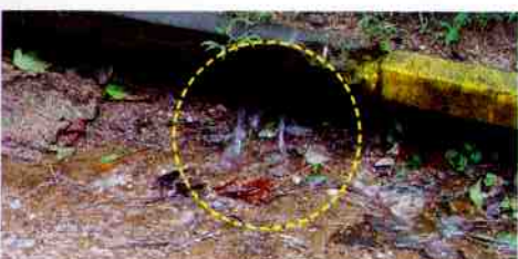
▲堤防法尻からの漏水状況 平成15年8月9日 台風10号(虎姫町唐国)
