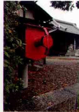
▲打込み式集水型消火栓(長浜市早崎町)
