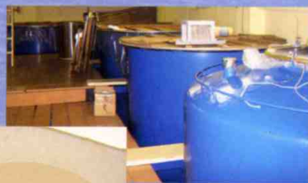
発酵タンク(奥)と貯蔵タンク(手前)
